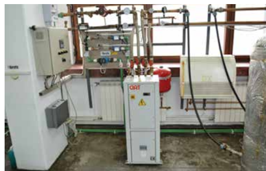
Део постројења геотермалне топлотне пумпе
