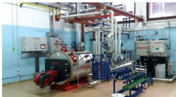
Котловско постројење Центра за обуку енергетских менаџера и овлашћених енергетских саветника (донација Владе Јапана)
