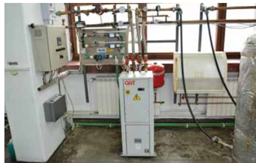
Део постројења геотермалне топлотне пумпе
